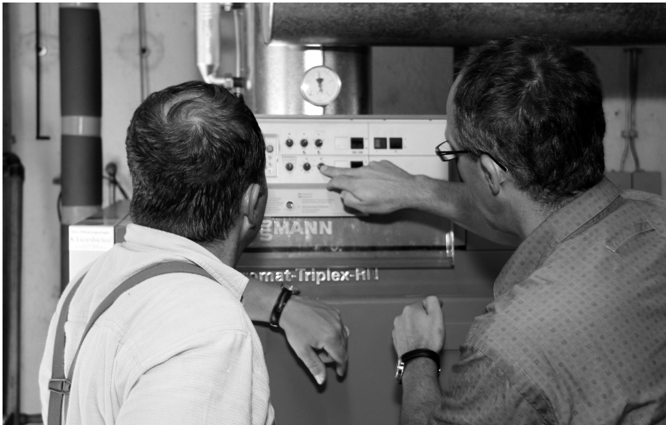
Фото 2: Завгосп та енергоменеджер перевіряють тепловий пункт. Фото EZA!
