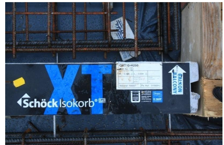
Isokorb на неопалювальній добудові
