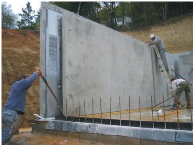
Підвал із термостінами з VIP, фірма Variotec
